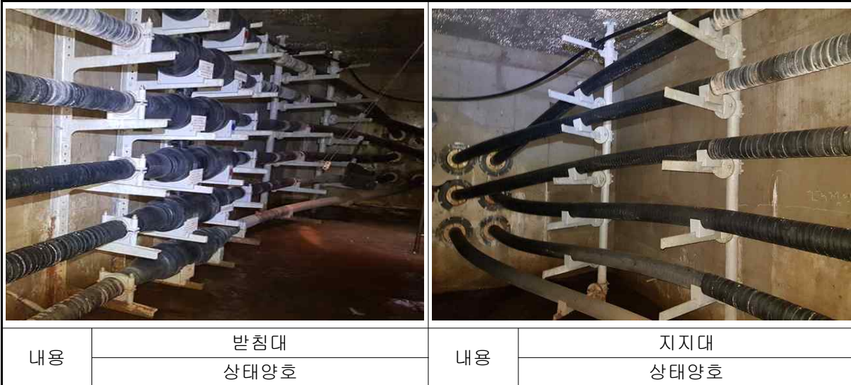
【사진 13.32】 부속 및 부대설비 현황
